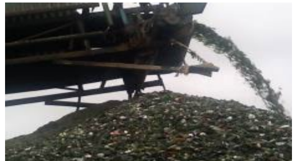
Figure 4 : manutention de calcin ménager
